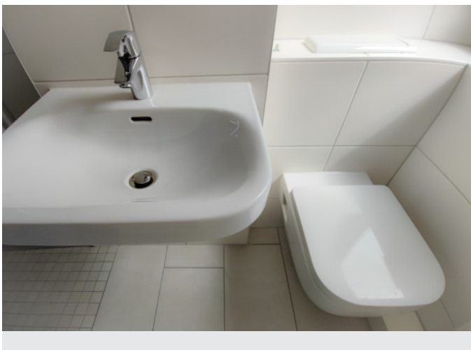
Bad mit moderner Sanitärausstattung
