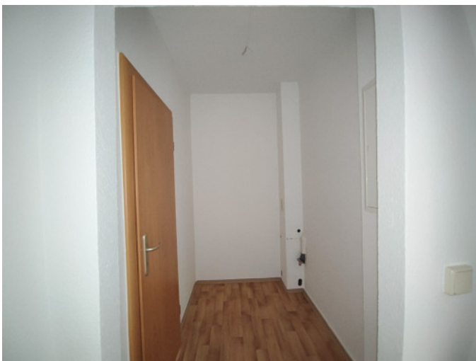
WM-Anschluss im Flur
