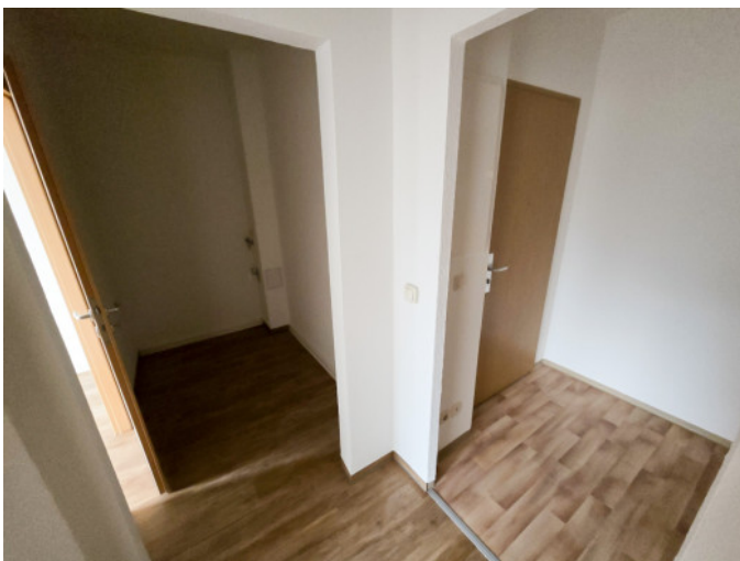
WM-Anschluss im Flur
